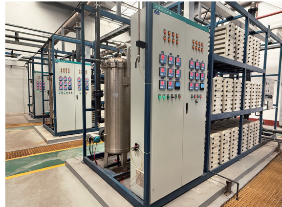
圖5-9 旭陽中燃水資源控制設備
