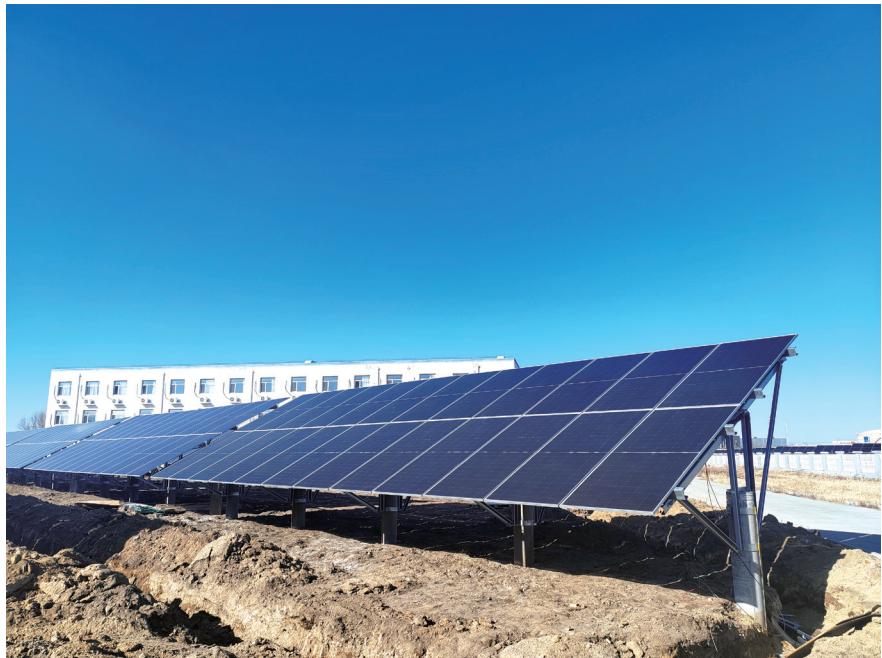
圖5-5 集團樂亭園區光伏設備
